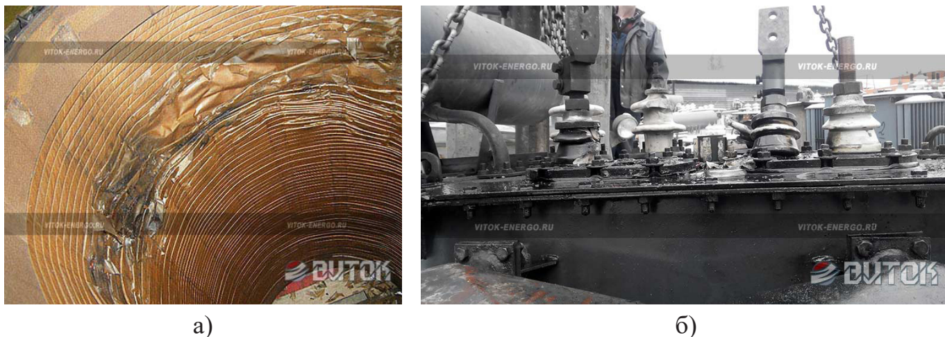
а) б) Рисунок 1 – Выгорание обмотки высокого напряжения трансформатора из-за короткого замыкания (а) и выгорание токопроводящих шпилек (б)
