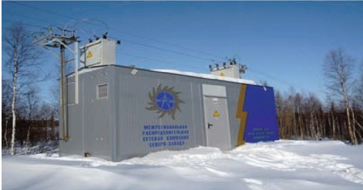
Рисунок 1 – Блок-контейнер пункта автоматического регулирования напряжения (БК ПАРН)
