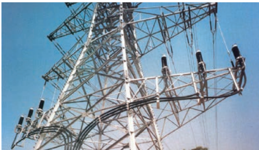
Рисунок 2 – Переходной пункт на опоре ВЛ
