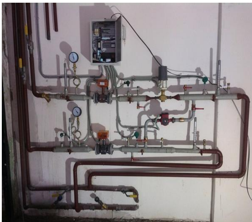
Рисунок 2 - Общий вид индивидуального теплового пункта с установленным на нем автоматизированным узлом управления
