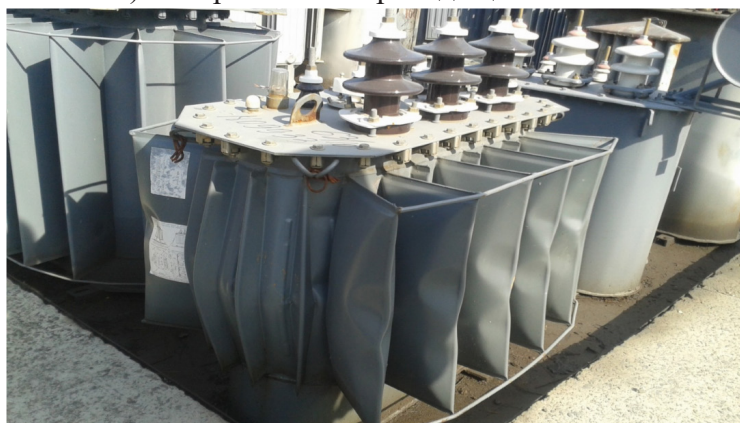
б) повреждение корпуса трансформатора ТГ в результате температурного расширения масла
