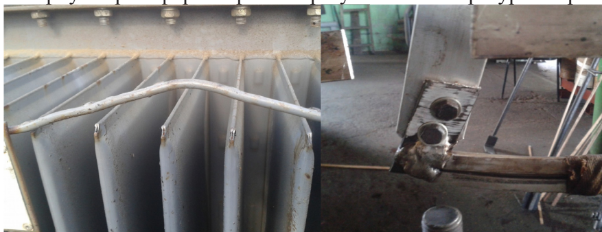
в) вторичные повреждения, вызванные перегревом
