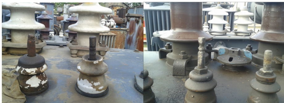
а) выгорание токопроводящих шпилек
