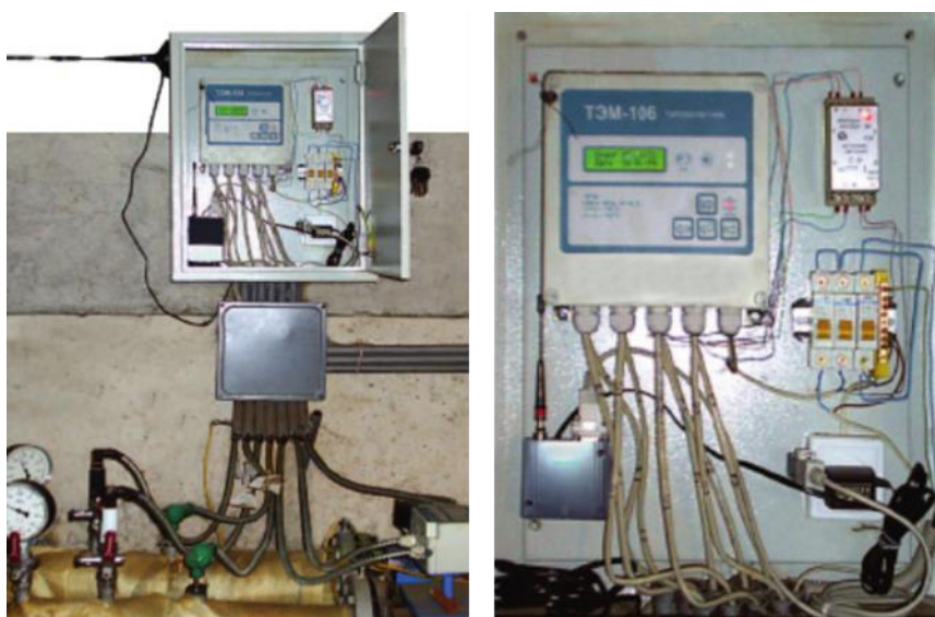
Рисунок 2 – Фрагмент системы. Подключение теплосчётчика и шкаф с теплосчётчиком и модемом
