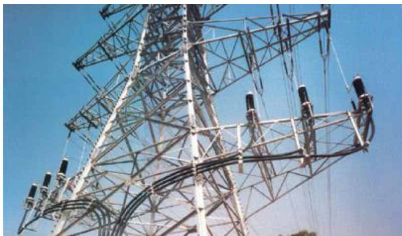
Рисунок 2 – Переходной пункт на опоре ВЛ
