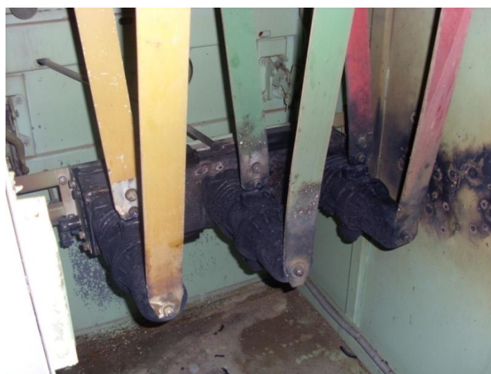
Рисунок 4 – Пофазное перекрытие выключателя
